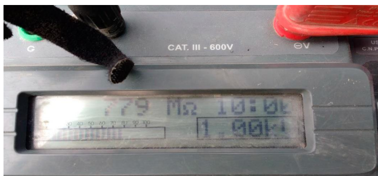
Slika 7 – Vrednosti testa izolacije rotora izmerene nakon otkrivanja kvara na rotoru.
